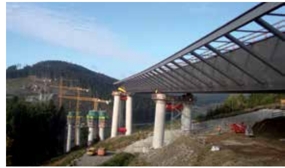
28 Vorbausechnabel vom Standpunkt Widerlager in Achse 80 © Max Bögl Bauunternehmung GmbH & Co. KG
