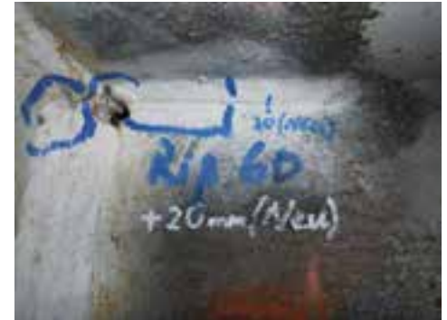
3 Risswachstum in der Seilkammer des Bestandsüberbaus © Landesbetrieb Straßenbau NRW
