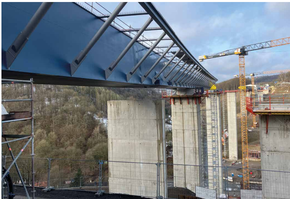
9 Baustelle der Talbrücke Rahmede mit Blick von Achse 60 nach Norden © Arbeitsgemeinschaft Talbrücke Rahmede
